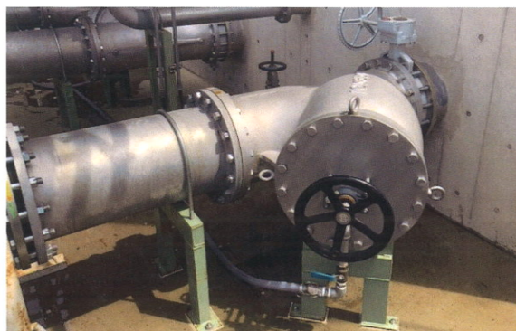
木質バイオマス発電所 冷却塔のポンプ保護用ストレーナ
